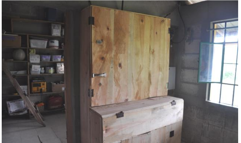
Nieuwe kast rond vernieuwde energiesysteem (handgemaakt door onze Martin)
